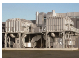
ロータリー型蓄熱式 直接燃焼脱臭装置
